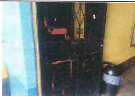
Foto 3: Puertas que necesitan mantenimiento
