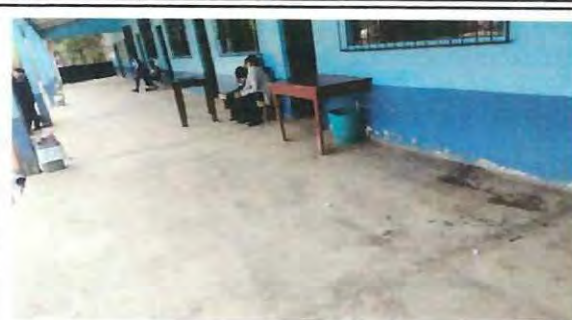
Foto 2: Piso del corredor que se necesita sustituir
