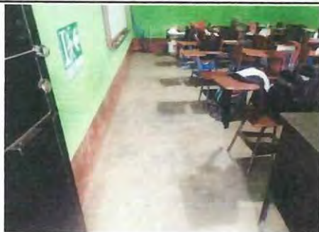
Foto1: Piso de aulas que se necesita sustituir.
