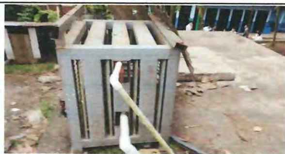
Foto 5: Bomba de agua que necesita sustitución.
